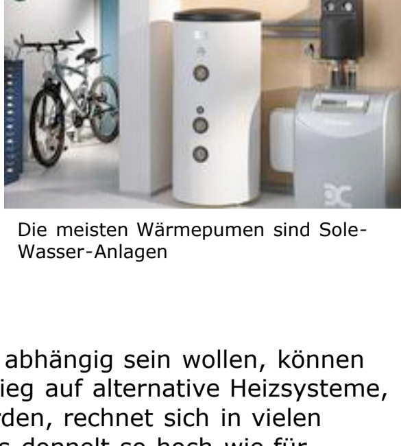
Die meisten Wärmepumpen sind Sole-Wasser-Anlagen
